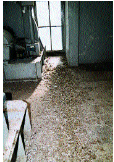
Abb. 10: Mit Taubenkot verunreinigter Maschinenraum eines Wehres in Brandenburg. Der Kot auf dem Fußboden sowie an den Maschinenteilen war überwiegend trocken. Zu Beginn der Messungen befanden sich einige Tauben im Raum
