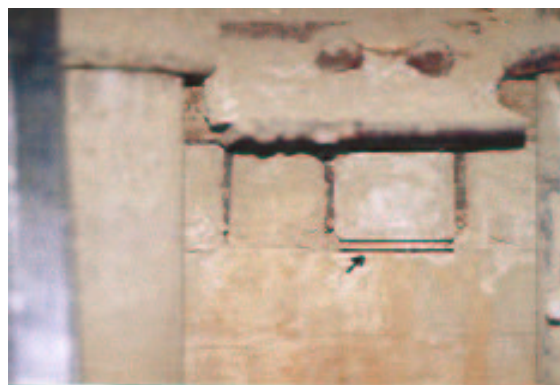
Bild 12: Feuerfestmauerwerk eines Kessels mit Arsen-, Cadmium- und PAK-Belastung, weiterhin sind asbesthaltige Fugenmassen und künstliche Mineralfaserprodukte eingebaut
