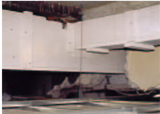
Bild 11: Asbesthaltige Platten als Brandschutzverkleidung an Stahlträgern im abgehängten Deckensystem sowohl im Abbruchbereich als auch im Teilnutzungsbereich vorhanden
