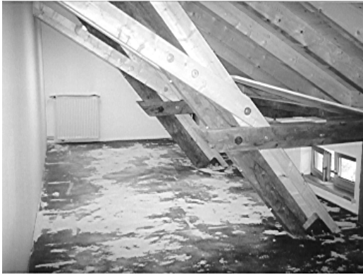
Bild 5: Permethrinhaltiger Dachstuhl aufgrund Schädlingsbekämpfungsmaßnahme
