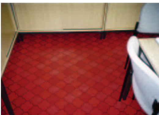
Bild 3: Asbesthaltiger Bodenbelag (Cushion-Vinyl)
