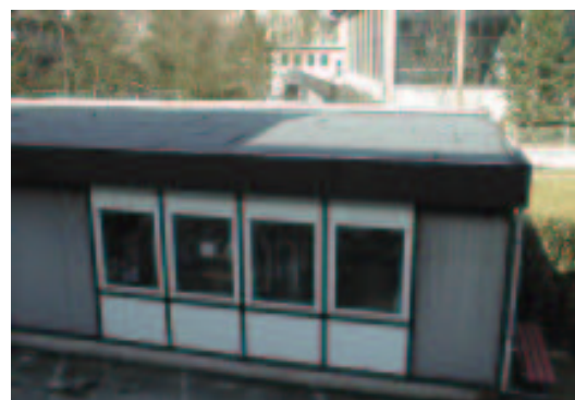
Bild 10: PAK-haltige Flachdachabdichtung eines Pavillons
