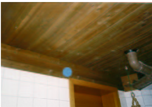
Bild 9: PCP-haltige Deckenverkleidung aus Holz
