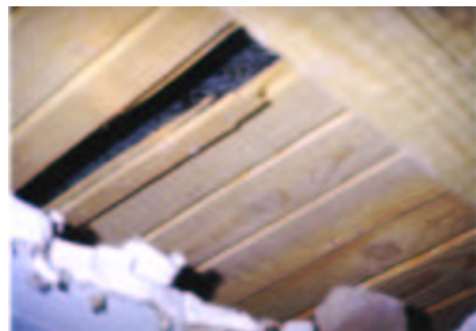
Bild 2: Spritzasbest hinter Rigips- und Holzdeckenverkleidung
