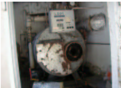
Bild 1: Asbest- und KMF-Produkte an Dampfkesseleinrichtungen und Rohrleitungen
